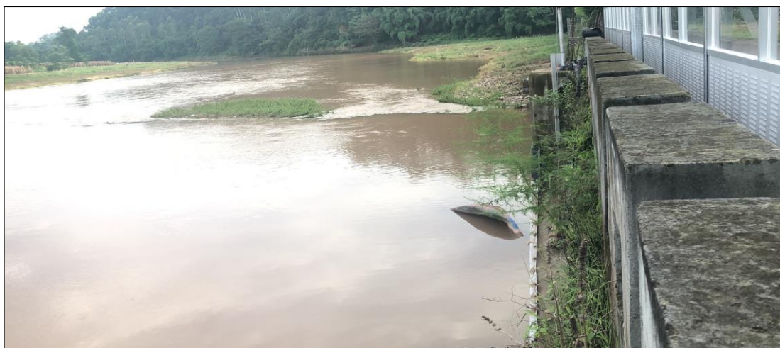
图 5-23 九宾湿地橡胶坝（塌坝）
